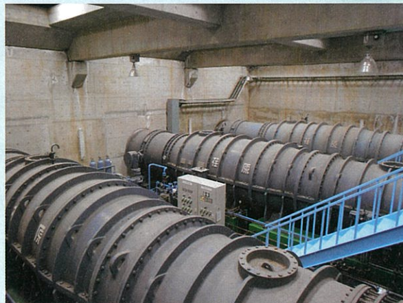
地下ポンプ室
