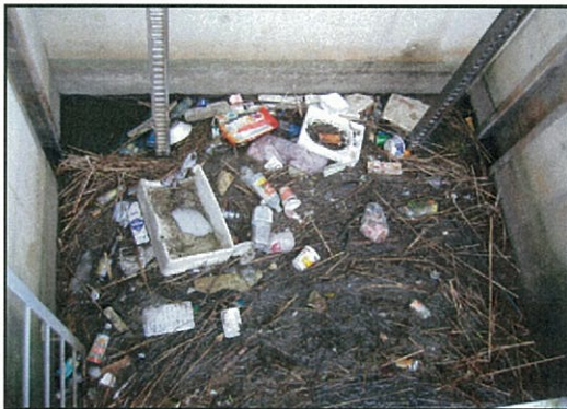
取水ゲートに溜まったゴミ
