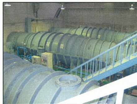
地下ポンプ室
